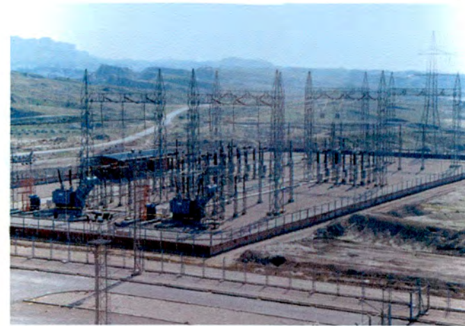
دکل شماره ۵۹ و پست برق بینک
