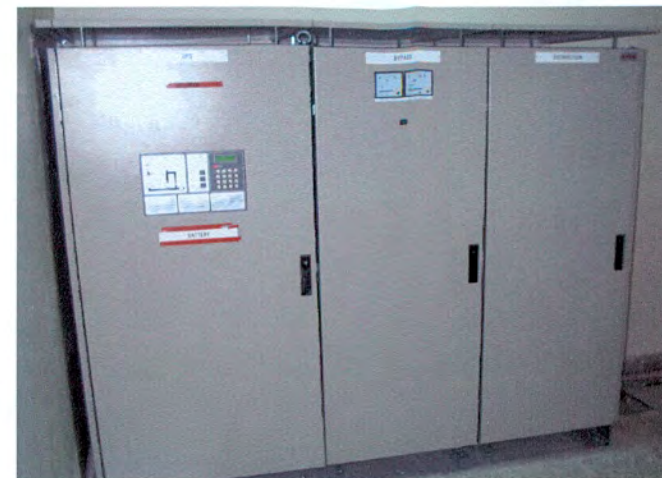
باتری شارژر های باتریهای ساختمان کنترل
