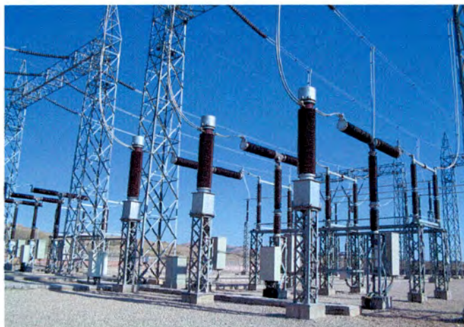
اتصال بین سکسیونرها ، کلید قدرت ، ترانسهای جریان و Over Span های پست برق بینک
