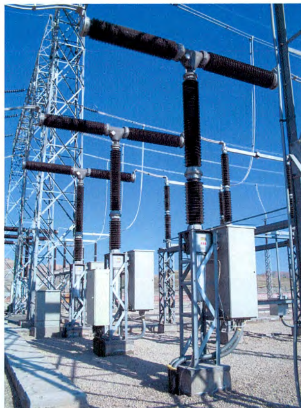
کلیدهای قدرت ، مکانیزمهای عملکرد و تابلوی مرکزی پست برق بینک
