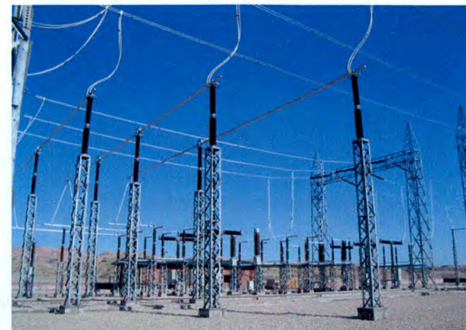
اتصال Over Span ها به باس بارهای لوله ایی پست برق بینک
