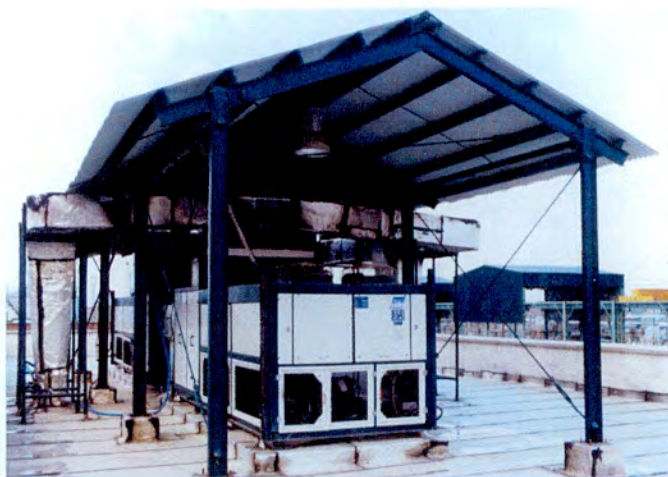
پکیج تولید و تهویه هوا ساختمان سوئیچگیر
