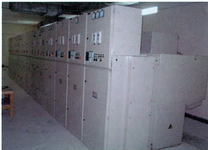
تابلوهای MV ساختمان سوئیچگیر
