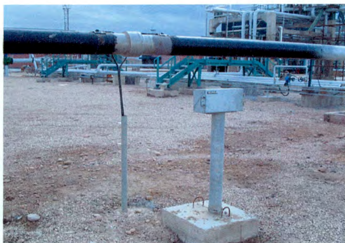
Insulating Joint خط لوله BCF به BCS
