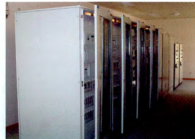
تابلوهای حفاظت ، اسکادا و باتری شارژرهای ساختمان کنترل پست برق بینک
