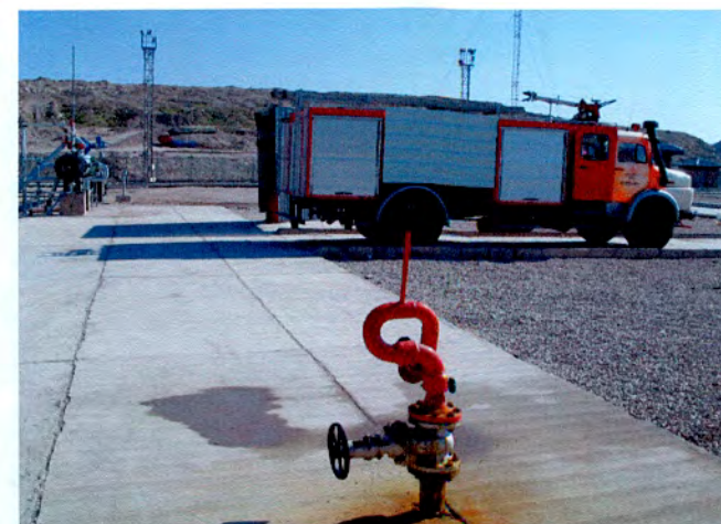
تجهیزات آتش نشانی محوطه BCS
