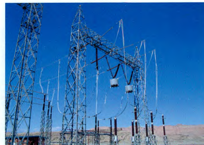
اتصال سیمهای هوایی به تله موجها و برق گیر پست برق بینک
