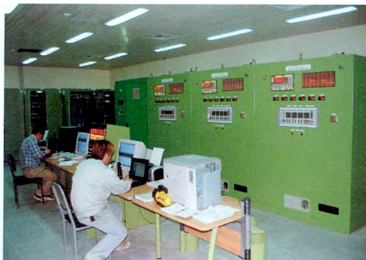
تابلوهای کنترل و راه اندازی کمپرسورهای گاز در اتاق کنترل محوطه BCS
