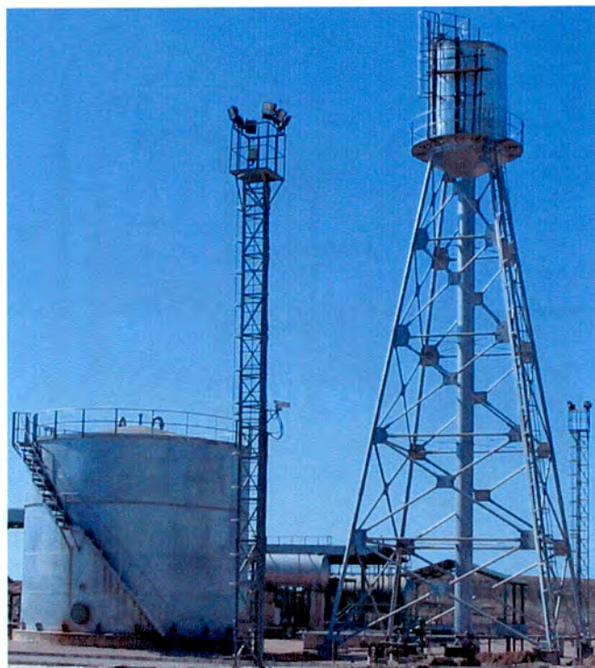
مخازن ذخیره آب آشامیدنی و آتش نشانی TK-4101,TK-4501
