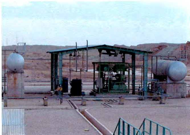
مخزن هوا ، سایبان تجهیزات جانبی و مخزن گازوئیل
