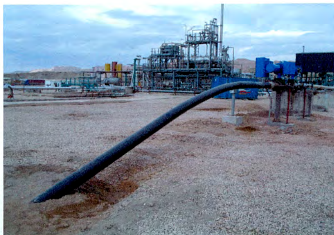
لوله خروجی گاز از ایستگاه BCS به ایستگاه SRF
