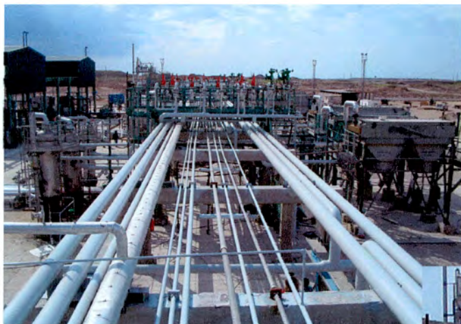
لوله های روی پایپرک
