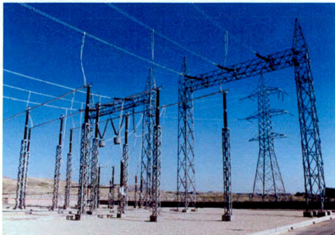
گنتریهای ابتدایی ورودی پست برق بینک و دکل شماره ۵۹
