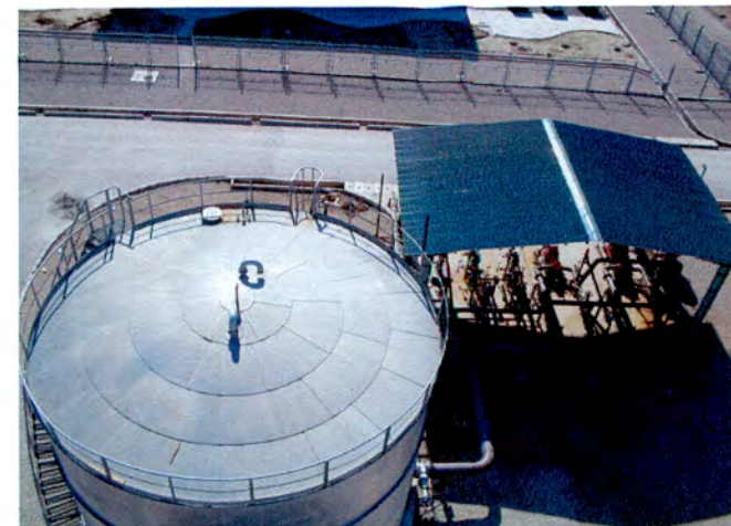
مخزن ذخیره و سایبان پمپهای آب آتش نشانی TK-4501
