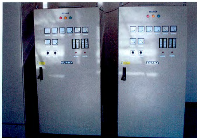
باتری شارژرهای ساختمان کنترل پست برق بینک
