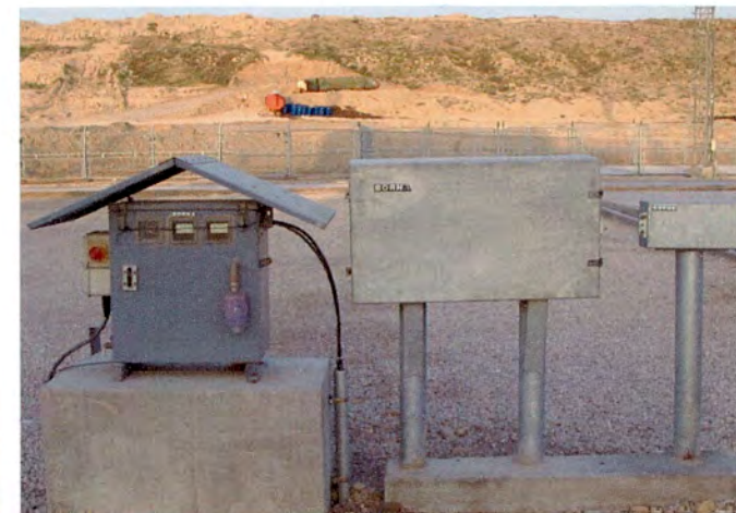
ترانسفورماتور سیستم حفاظت کاتدیک مسیر خط لوله BPUCF به BCS
