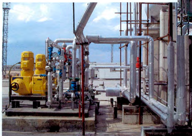
لوله های عایقکاری شده انتقال گلاپکل
