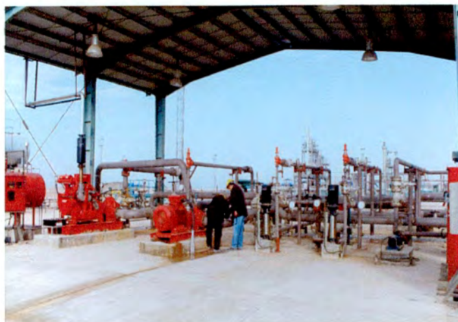
پمپهای آب آتش نشانی محوطه BCS
