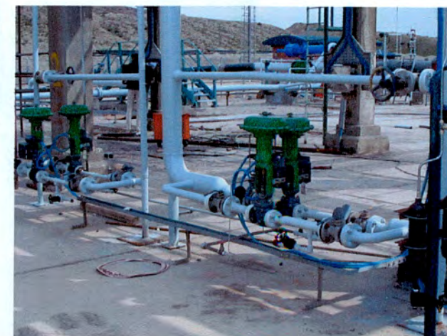
شیرهای کنترل محوطه BCS
