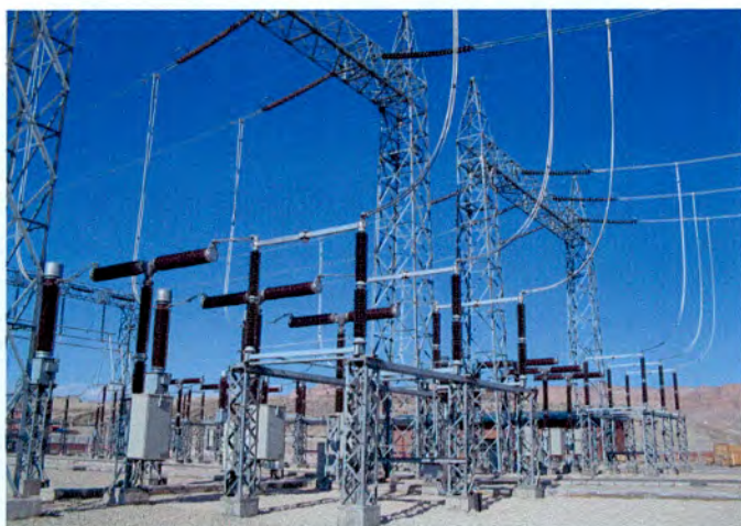
اتصال بین سکسیونرها ، کلید قدرت و Over Span های پست برق بینک
