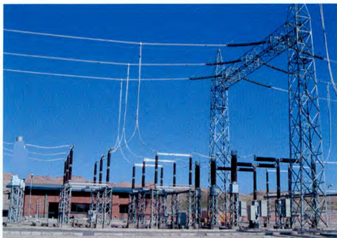
اتصال سکسیونرهای ساده به Over Span های پست برق بینک
