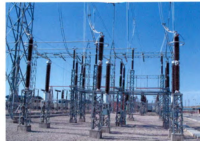
اتصال تجهیزات سر خط (برقگیر و ترانس ولتاژ جریان ) پست برق بینک
