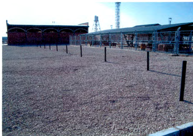
لوله های Vent سیستم حفاظت کاندی خط لوله BPUCF به BCS
