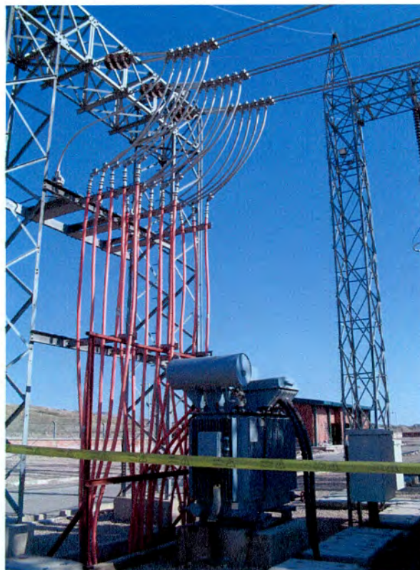
ترانسفورماتور کمپکت کمکی و زمین پست برق بینک
