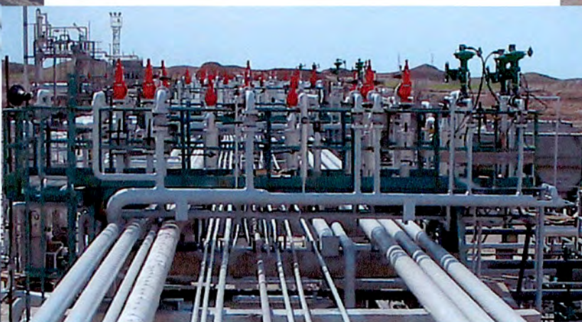
شیرهای اطمینان و کنترل روی پایپرک
