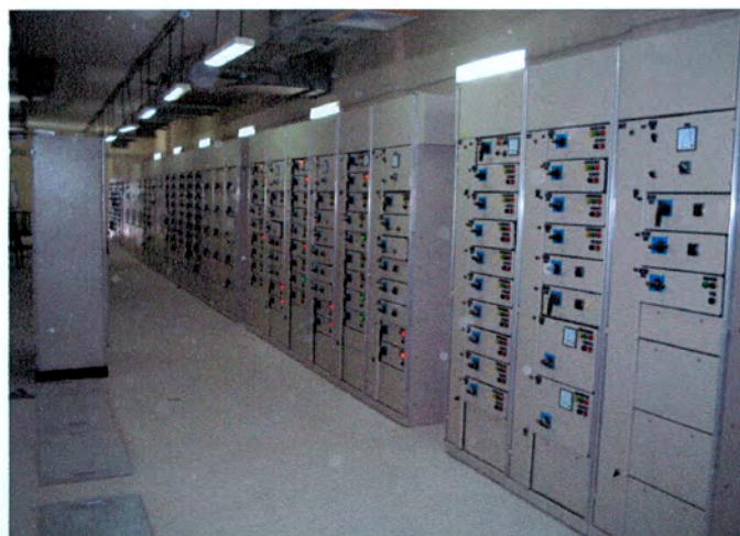
تابلوهای LV و Inter posing ساختمان سوئیچگیر
