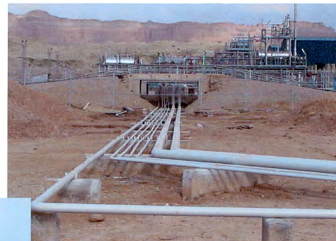
لوله های خروجی از محوطه BCS به برجهای سوزا
