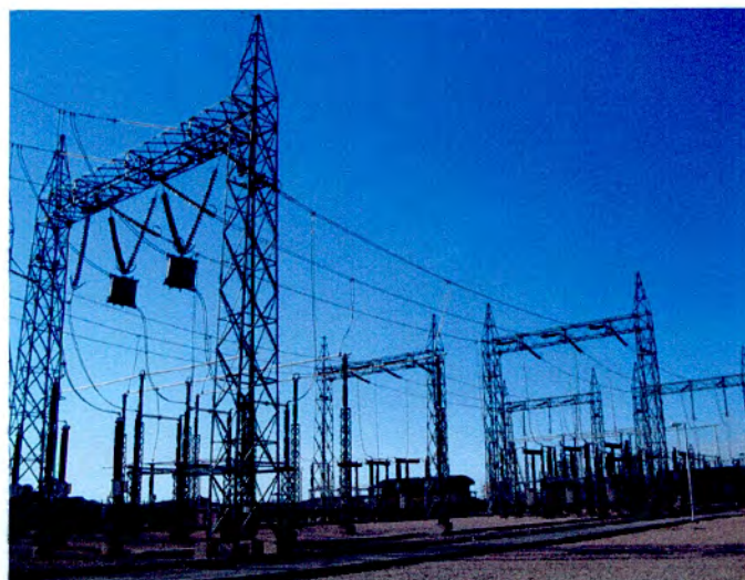
نمای خارجی از پست برق بینک
