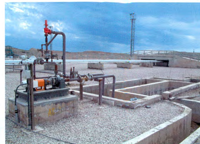
پمپ P-4305 و حوضچه Oily Water Separator
